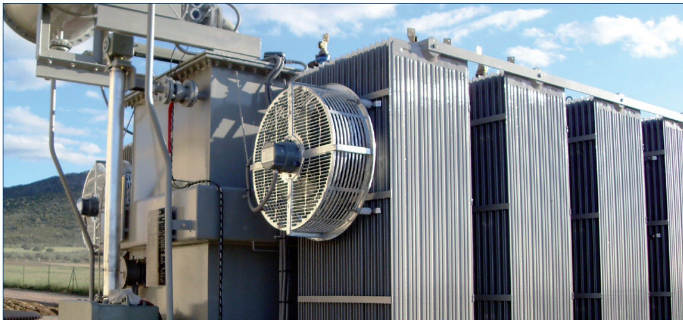
Trafoanlage des spanischen Solarparks
