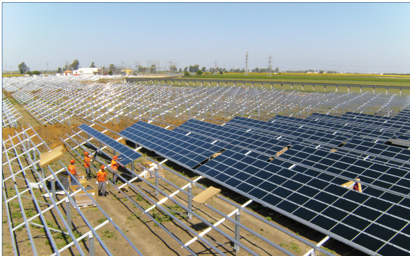
Der Bau der Anlage im sachsen-anhaltinischen Helbra soll im Oktober 2010 abgeschlossen sein. Durch seine Stromproduktion werden jährlich ca. 8.000 Tonnen CO 2 eingespart. (Quelle: Unternehmen)
